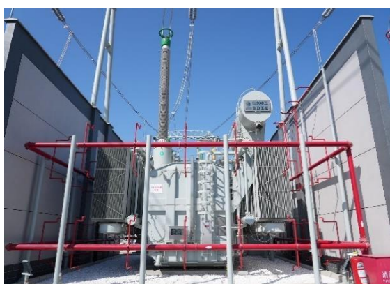
现有主变及防火墙
