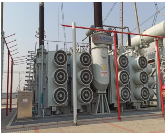
现有主变及防火墙
