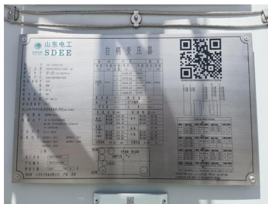
现有主变设备铭牌
